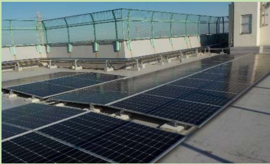
I【船橋市】避難所施設等への再生可能エネルギー設備導入等事業 連携先:TN クロス
