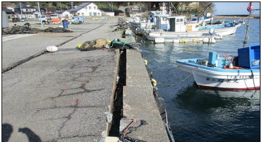
漁港被害（ひび割れなど）
