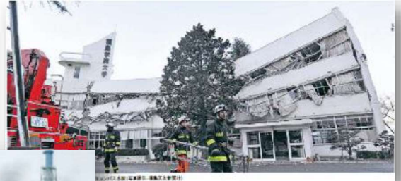
倒壊した福島学院大学宮代キャンパス本館 (福島民友より)
