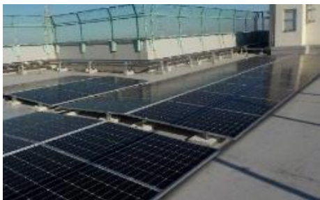
▲【船橋市】避難所施設等への再生可能エネルギー設備導入等事業
